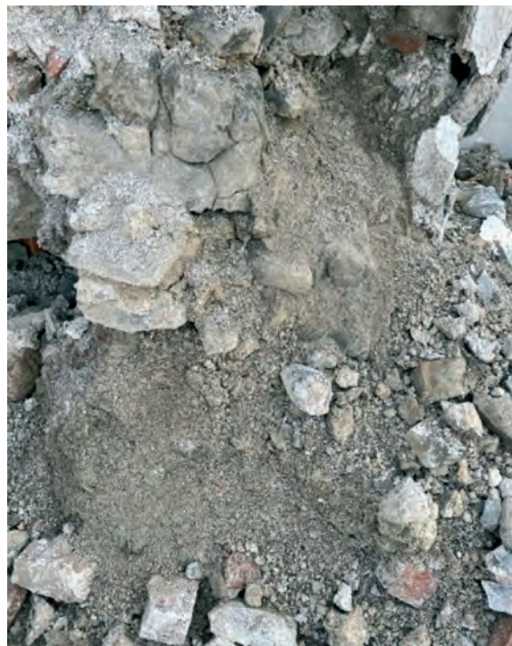
– Zustand Mauerwerk: Kalk-/Sandgemisch nach Regen –
