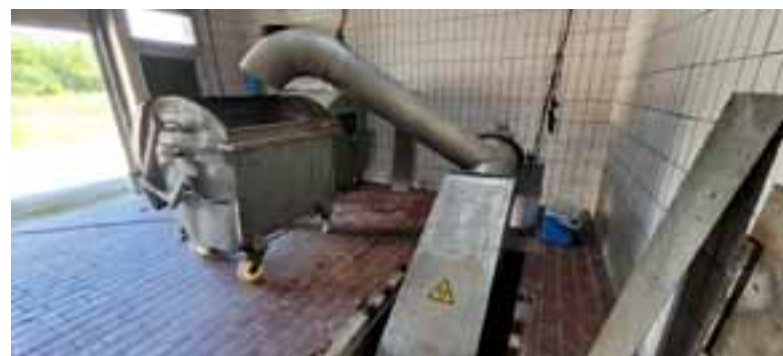
Der „sichtbare“ Teil des Rechens. Die Förderschnecke mit Abwurfbehälter
